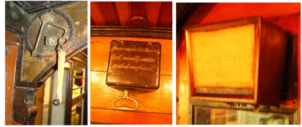
Fig. 12.: Alarm rod – emergency breaker – loudspeaker (URM)
